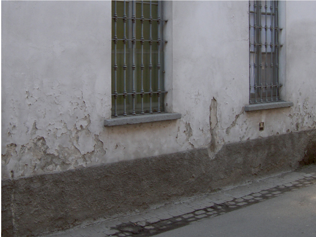
La stollatura della superficie inferiore della muratura non può arrestare il degrado dell'intonaco causato dall'umidità di risalita.
