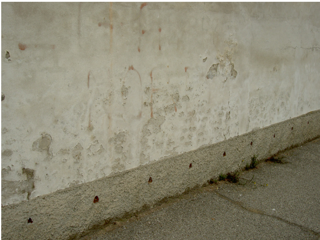
La stollatura della superficie inferiore della muratura e l'inserimento di fori di aerazione non possono arrestare il degrado dell'intonaco causato dall'umidità di risalita.
