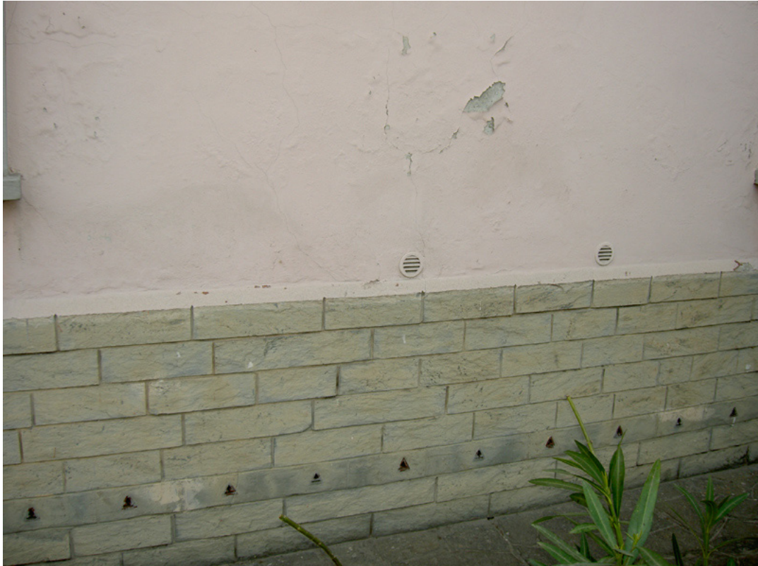
Il rivestimento della superficie inferiore della muratura mediante mattonelle di pietra e l'inserimento di fori di aerazione non possono arrestare il degrado dell'intonaco causato dall'umidità di risalita.
