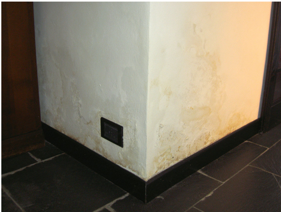
Danni causati dall'umidità di risalita: ingiallimento dell'imbiancatura, distacco dell'imbiancatura e della stabilitura.
