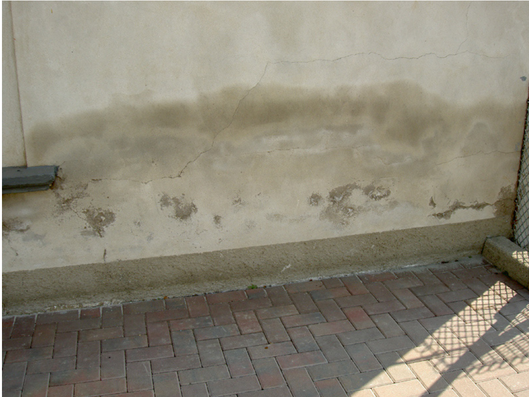
Danni causati dall'umidità di risalita: effetto bagnato marcato, distacco della tinteggiatura e della stabilità.
