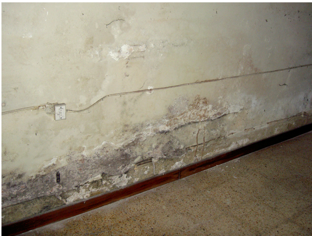
Danni causati dall'umidità di risalita: distacco dell'imbiancatura, della stabilitura e dell'intonaco, e formazione di muffe.
