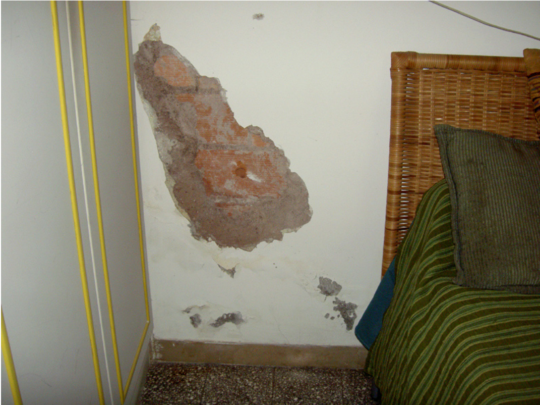
Danni causati dall'umidità di risalita: distacco dell'imbiancatura, della stabilitura e dell'intonaco.
