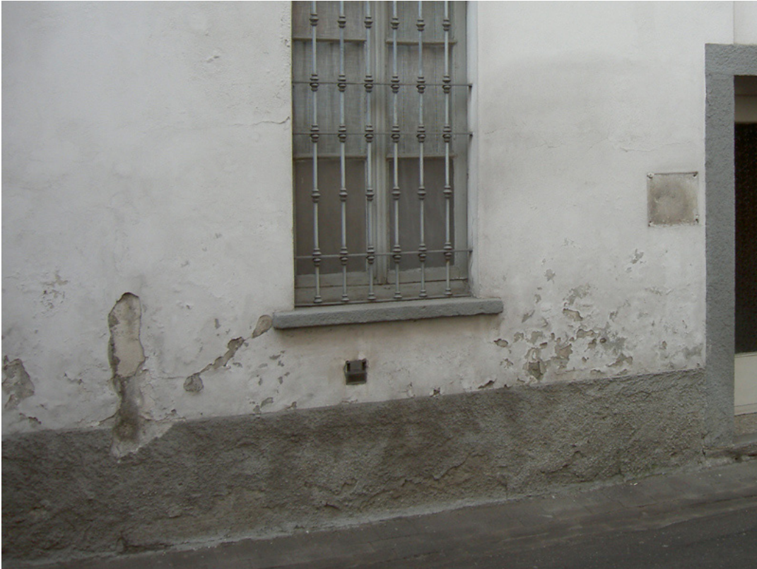
Danni causati dall'umidità di risalita: effetto bagnato, distacco della tinteggiatura e della stabilitura.
