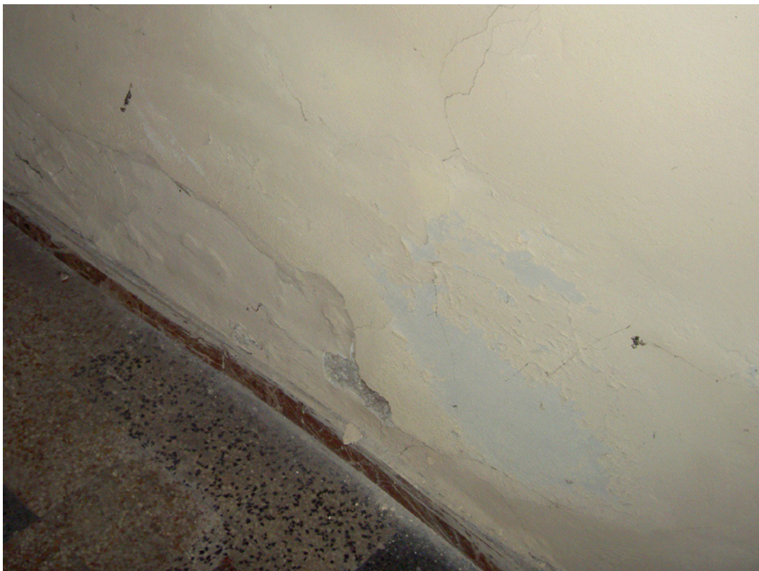
Danni causati dall'umidità di risalita: effetto bagnato, distacco dell'imbiancatura e della stabilitura.
